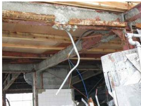
建物に残存した吹付け材
